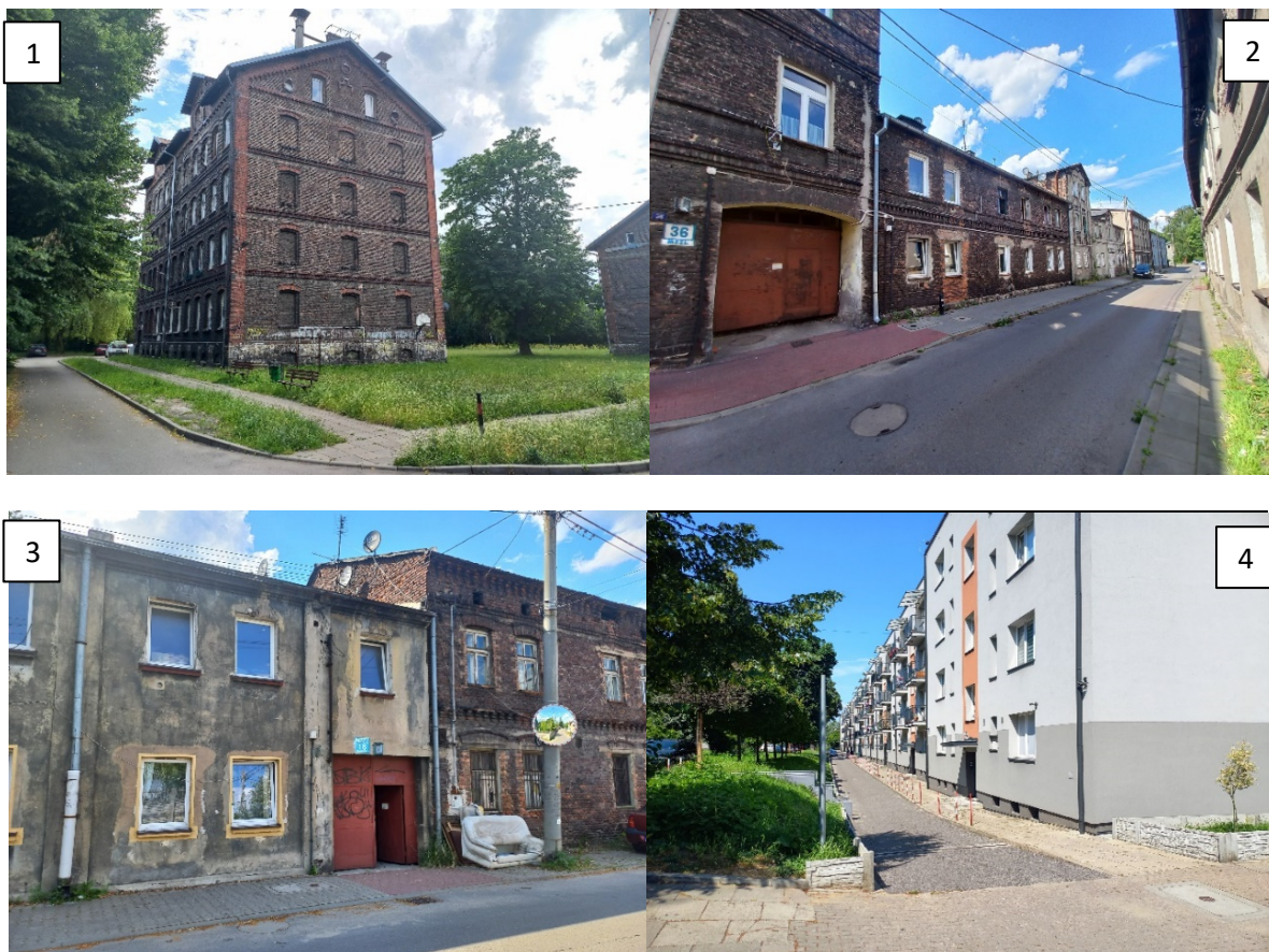
1. Stara zabudowa przy ulicy Chemicznej, 2. Jedna z najstarszych części dzielnicy ulica Rybna, 3. Budynki wymagające interwencji technicznej, 4. Odnowione budynki przy ulicy Lwowskiej, która wykazuje wysokie natężenie problemów społecznych.
